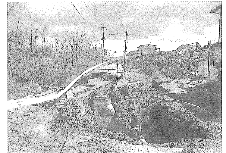
写真-2 道路・管路の崩壊
