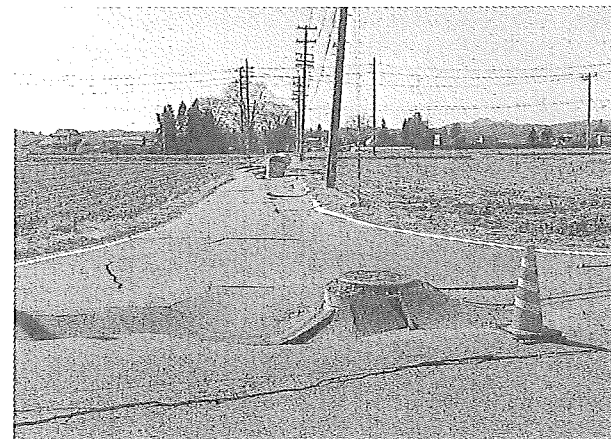
写真-1 管路埋設部の道路陥没とマンホールの浮上
