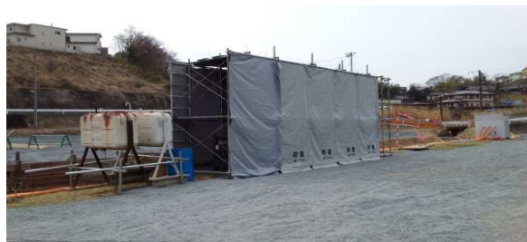
・ 空気圧縮機の防音対策状況
